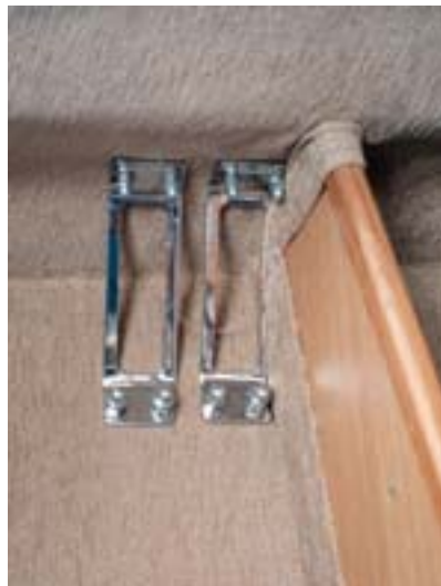
Die Püttinge leckten an der Backbordseite: zu schwach ausgeführt?
